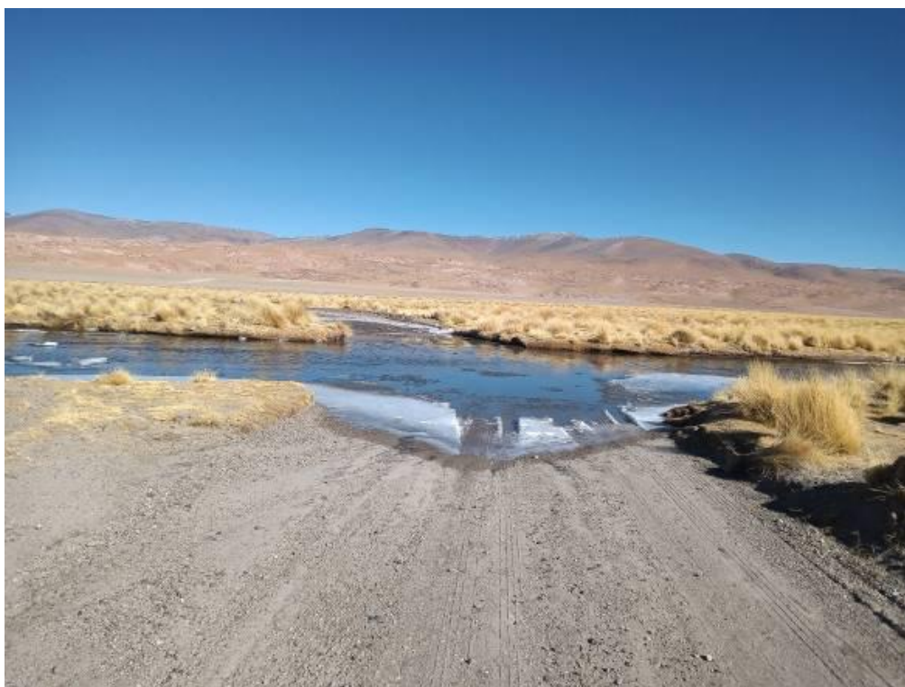
Foto II-85. Vista del estado actual del cruce sobre el río de Los Patos
